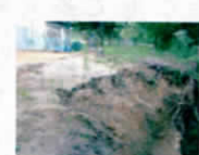
マレット場崩落
